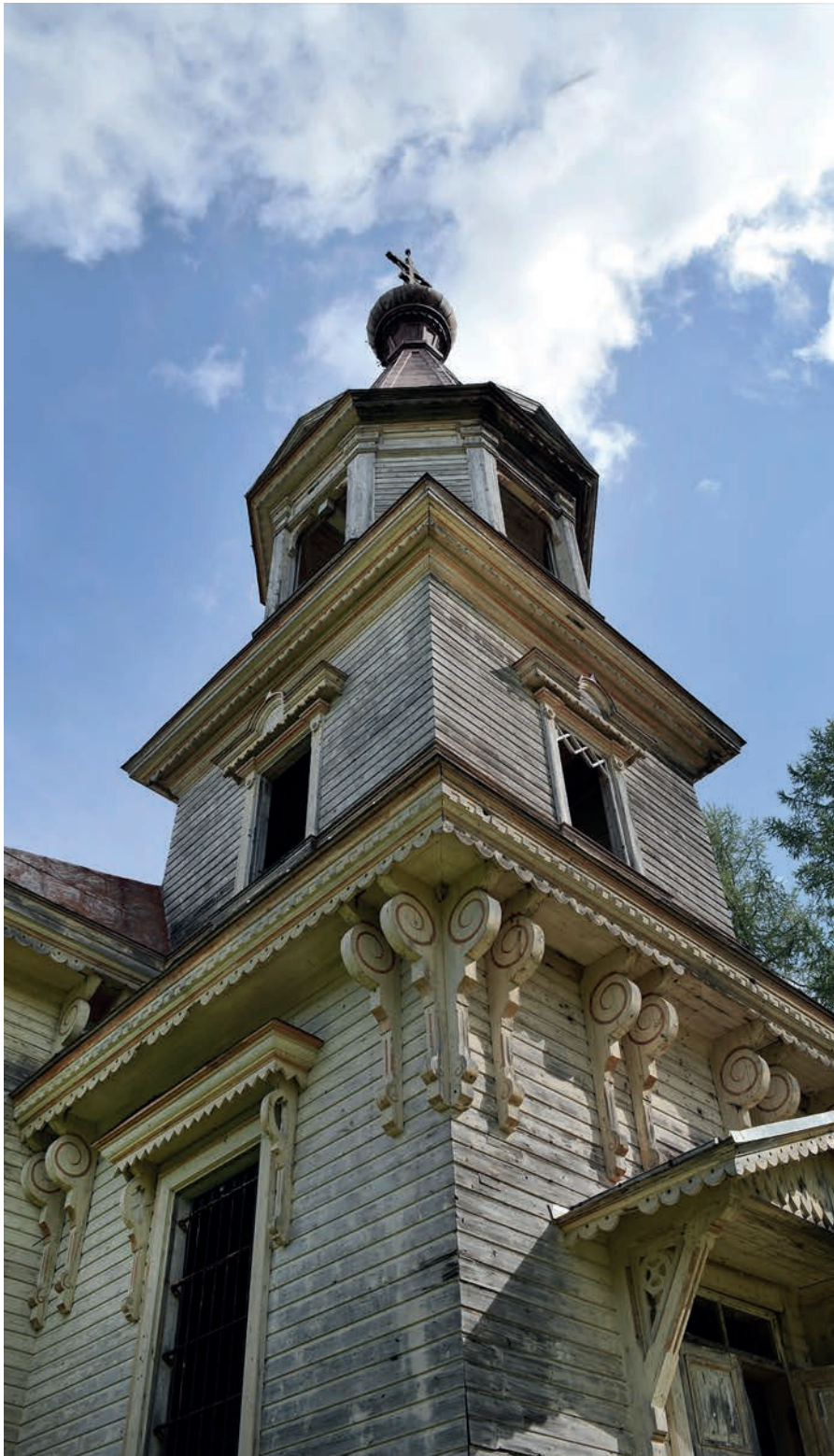
Korpiselän kirkon etutorni nykyisin. Kirkkoa korjattiin 1930-luvulla sekä sisältä että ulkoa. Ilmeisesti tällöin fasadiin lisättiin pieniä puukoristeita.
