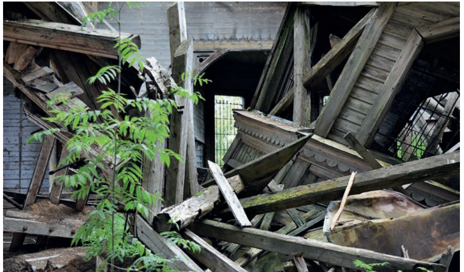
Nykyisin kirkon ristikeskiön kupolitorni on romahtaneena, katto alkoi pettää 2000-luvun ensimmäisellä vuosikymmenellä.
